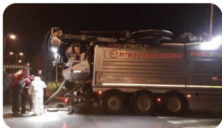
Откачка сточных вод – Кирьят Шмона
